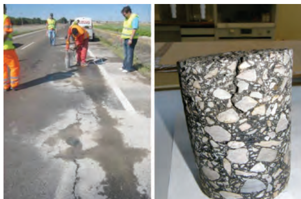
Figura 4. Extracción de testigos en la CL-602. El testigo evidencia fisuración descendente.
