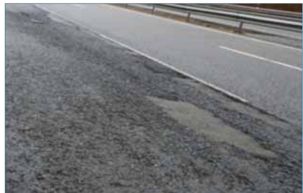
Fig. 2 Degradación prematura de reparación de fresado y reposición efectuada en condiciones de lluvia y temperaturas bajas
