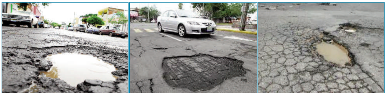
Figura 1. Daño por humedad en vías mexicanas (Excélsior, 2015)
