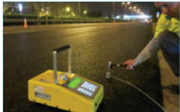
Medida de la impedancia mecánica en un tramo de ensayo.
