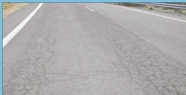
Figura 42. Grieta estructural típica por fatiga de alguna capa del firme.
