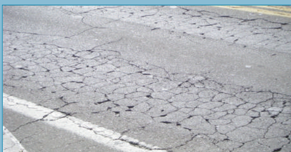
Figura 40. Fisuración estructural en zona de rodadas.
