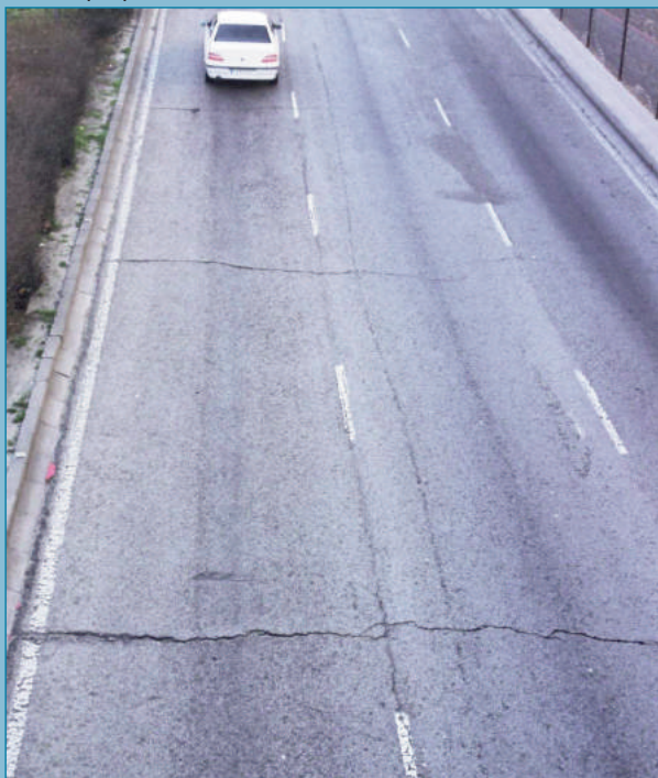
Figura 49. Superficie de rodadura con grietas reflejadas.
