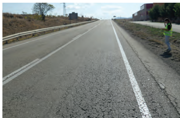
Agrietamiento grueso en las rodadas.
