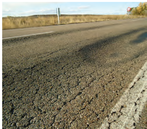
Agrietamiento grueso en las rodadas.
