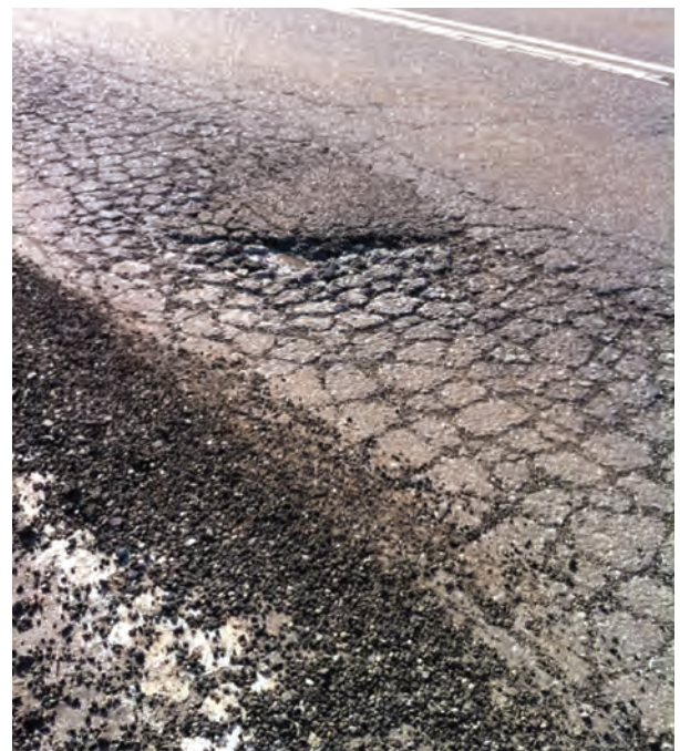
Zona de deterioro estructural (capas subyacentes) y reparación inadecuada de baches.
