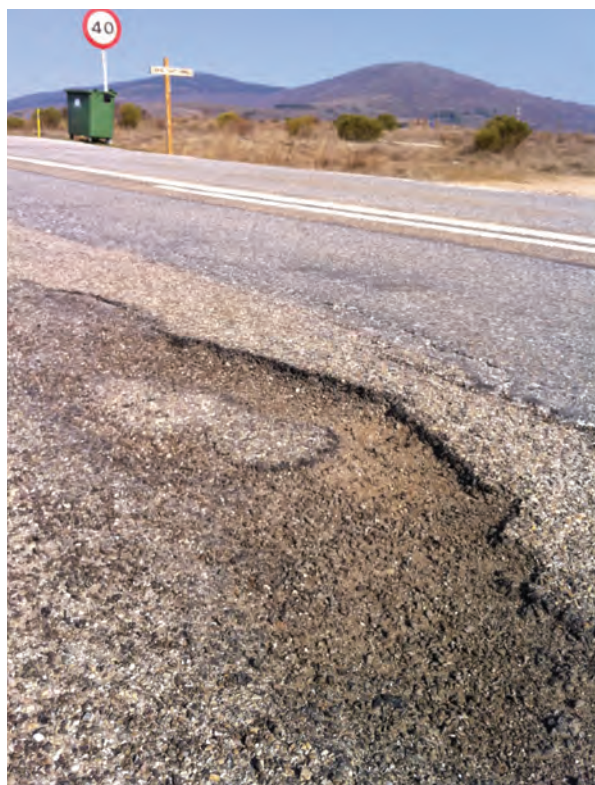
Deterioro del borde.
