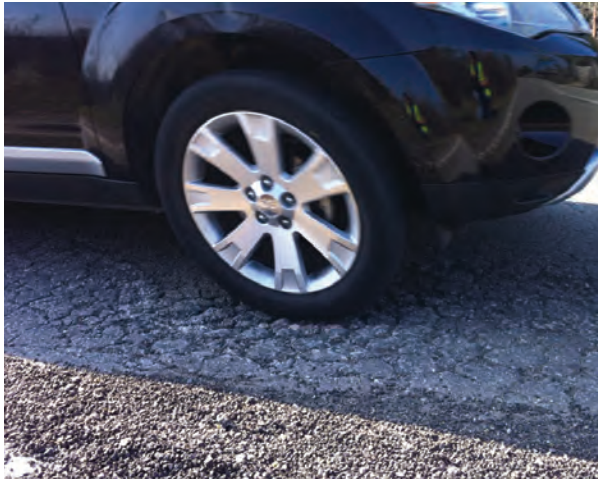
Deterioro estructural, es decir, no sólo en la superficie, sino en las capas subyacentes.
