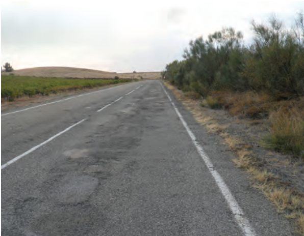
Agrietamiento grueso en las rodadas.
