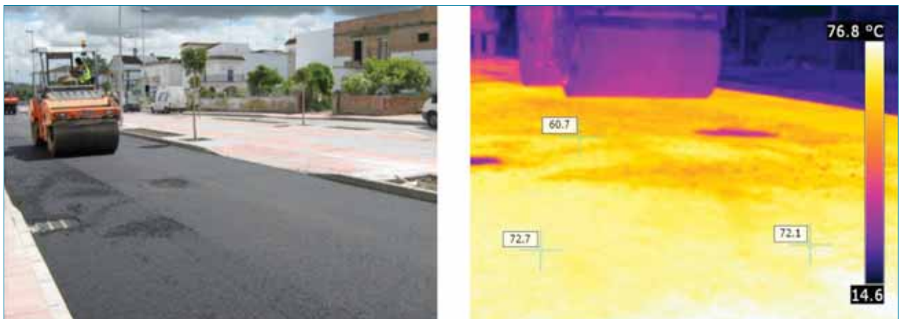
Figura 7. MBT: Termografía de la temperatura de la mezcla durante la compactación con rodillo.
