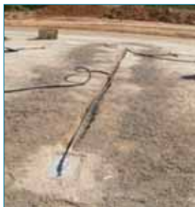
Figura 12. Fotografía de instalación célula de carga.
