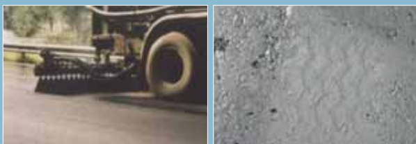
Ejecución correcta del riego.
