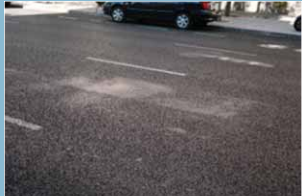
Exudaciones por exceso de riego de adherencia.
