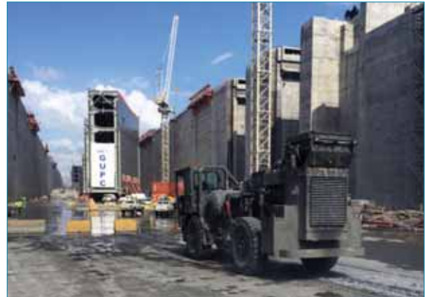
Foto 16. Panorámica de la obra del canal y el equipo de desintegración trabajando.
