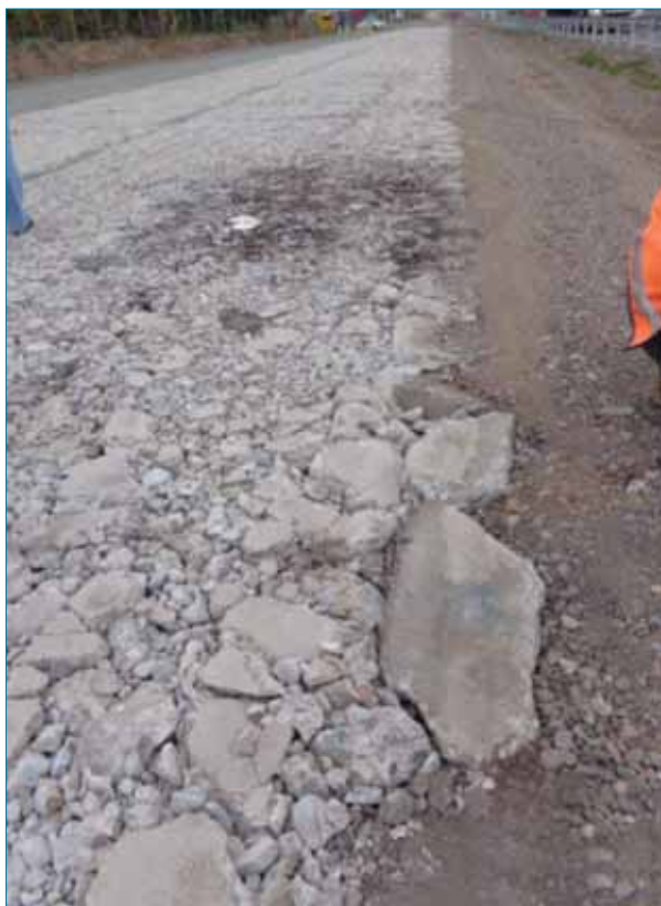
Foto 6. Zona deformada por problemas de base. Detalle de una zona puntual con desintegración incorrecta.
