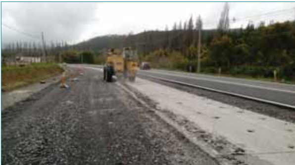
Foto 10. Desintegración de doble losa de hormigón. Paso 2: Desintegración del pavimento.
