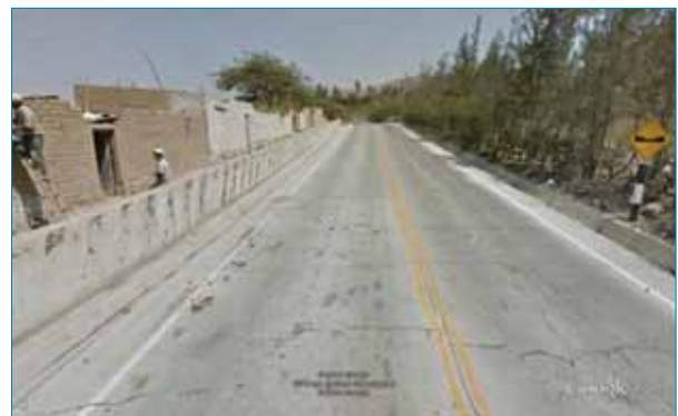
Foto 2. Tramo con muro demasiado cercano a la carretera.
