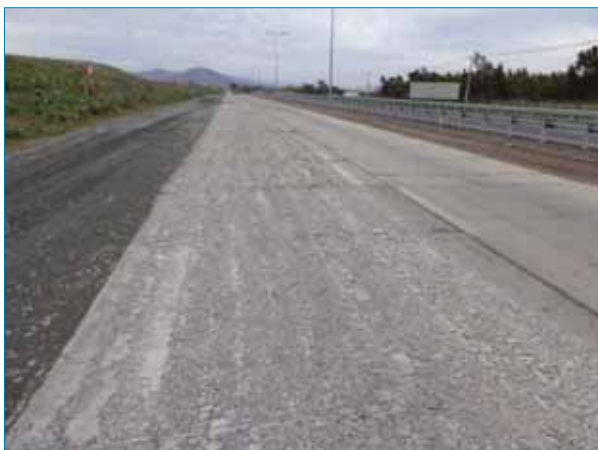
Foto 12. Tramo después de la desintegración de un carril.
