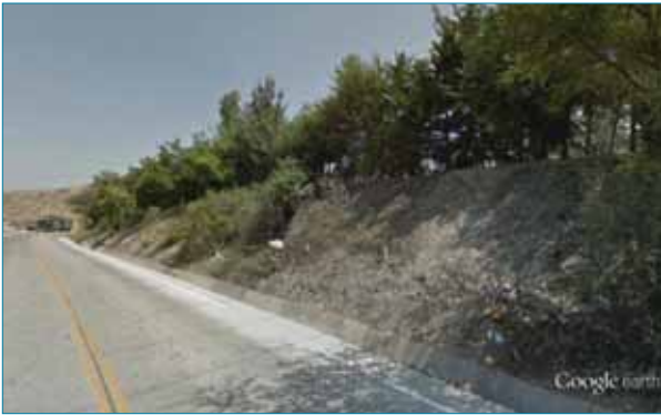
Foto 3. Tramo con talud demasiado cercano a la carretera.
