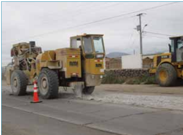
Foto 1. Desintegración de pavimento de hormigón en Ruta 43. Tramo urbano Pan de Azúcar (Chile)
