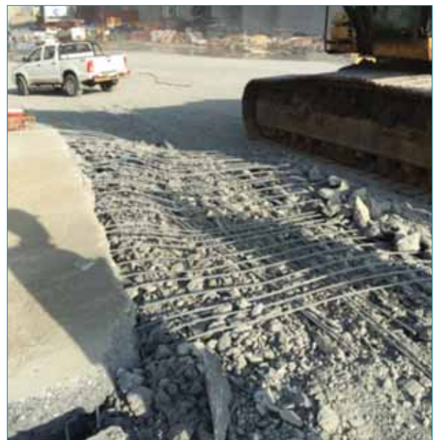
Foto 17. Detalle de la armadura del pavimento despegada del material desintegrado.
