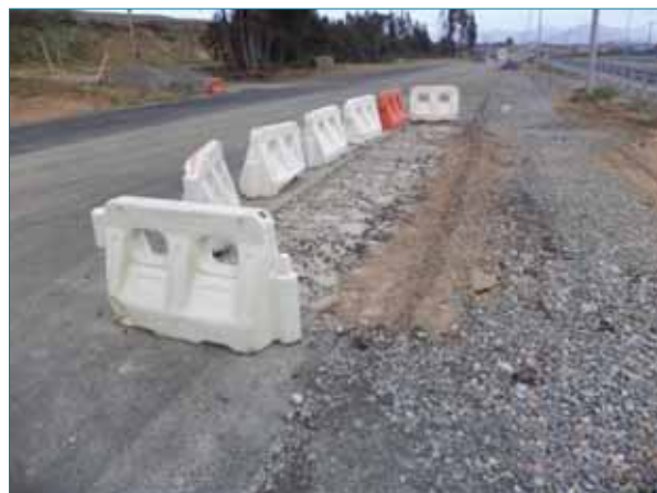
Foto 7. Zona deformada por problemas de base. Detalle de la retirada de la capa de mezcla bituminosa antes de la sustitución del material.
