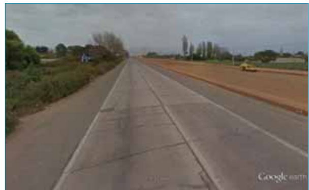
Foto 11. Aspecto del pavimento de hormigón antes de la desintegración.
