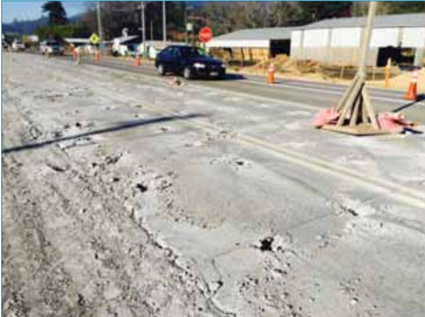
Foto 9. Desintegración de doble losa de hormigón. Detalle de los taladros en el pavimento.
