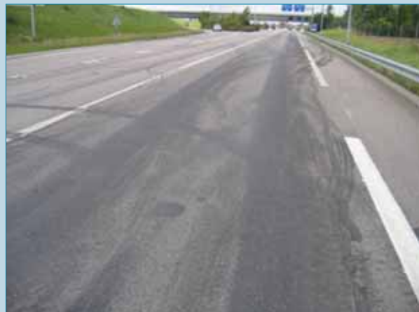
Foto 2. Restos de betún en el entorno de la obra arrastrados por las ruedas de los camiones. Además del problema estético la alteración de las marcas constituye un problema de seguridad (foto cedida por grupo SANEF).
