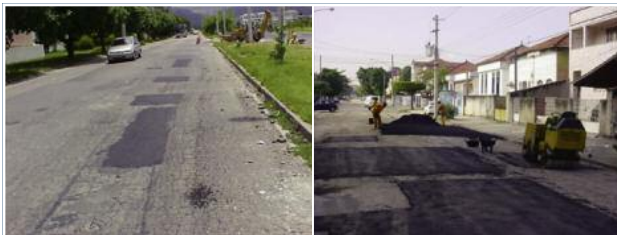
Fotos de Vias com Restaurações tipo Tapa-Buracos.
