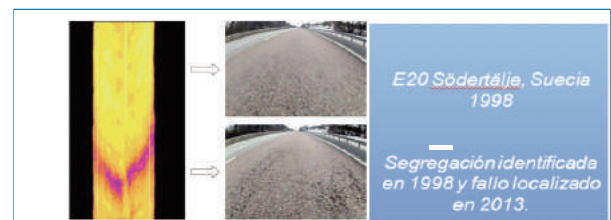
Figura 16. Efecto de las zonas frías en el extendido sobre el comportamiento del pavimento. Fuente [7]
