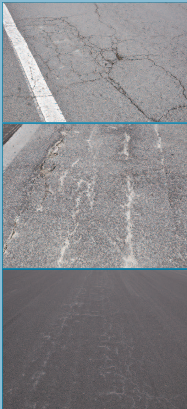
Figura 110. Surgencias de finos y agua en distintos tipos de firmes.
