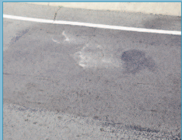
Figura 111. Surgencias de finos y agua en zona insuficientemente reparada anteriormente. No se resolvió el problema de finos de mala calidad en capas inferiores.
