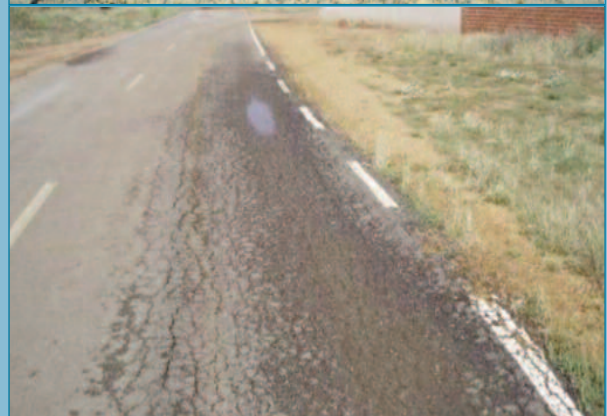
Figura 112. Surgencias de agua y finos como consecuencia de zahorra plástica y falta de drenaje longitudinal.
