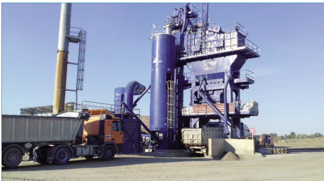
Figura 5. Fotografía de la instalación de fabricación de las mezclas bituminosas.
